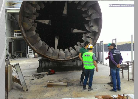
Kurutucu Trommel Revizyonu
